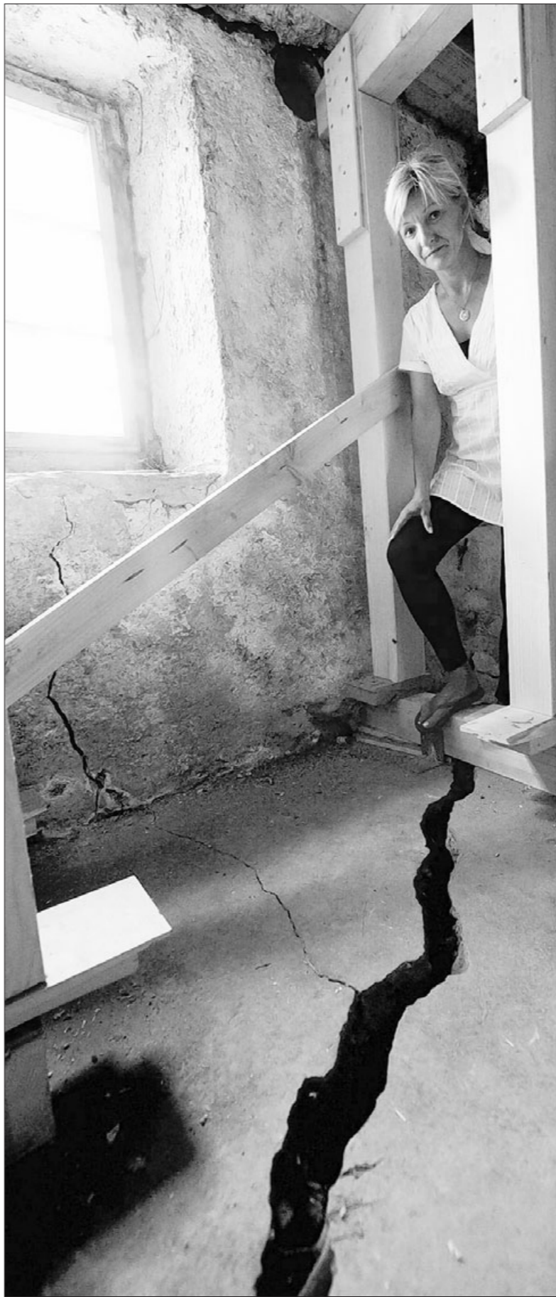
Zentimeterbreite Risse klaffen in Staufener Gebäuden auch in den Böden. Ursache sind Hebungen im Untergrund der Altstadt. Foto: ddp
